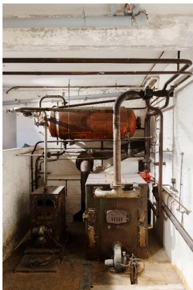
42. Chaudières et ballon d'eau chaude
